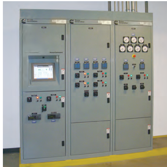
Działanie systemu jest nadzorowane przez dwa sterowniki PowerCummins® DCM 300 oraz przez rozdzielnicę z frontowym interfejsem.
