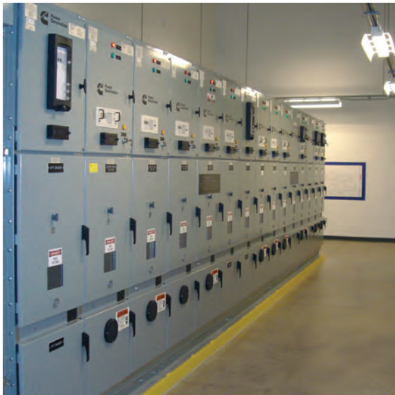
Rozdzielnia zapewni przeniesienie mocy pomiędzy agregatem, a pozostałymi urządzeniami.
